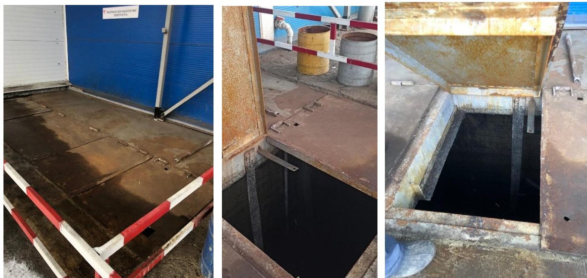
Рис. 1.6. Подземная накопительная емкость объемом 140 м 3
