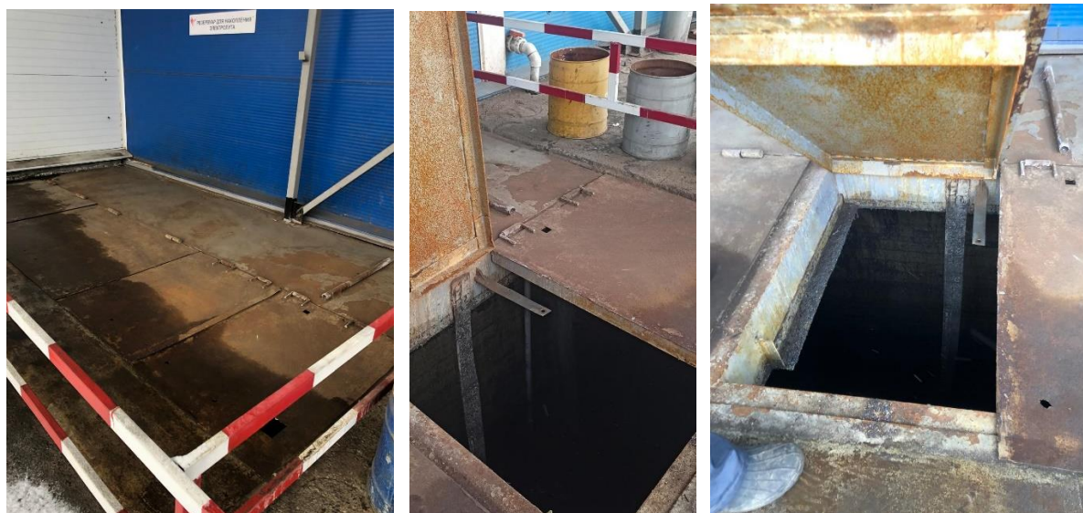
Рис. 1.6. Подземная накопительная емкость объемом 140 м 3
